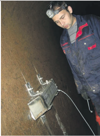
Die Montage der Geräte erfordert Know-how. Fotos: Medon (3)
